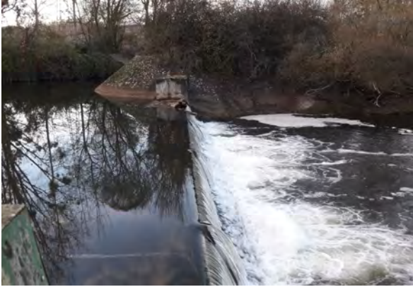
Vue du clapet depuis la rive droite
