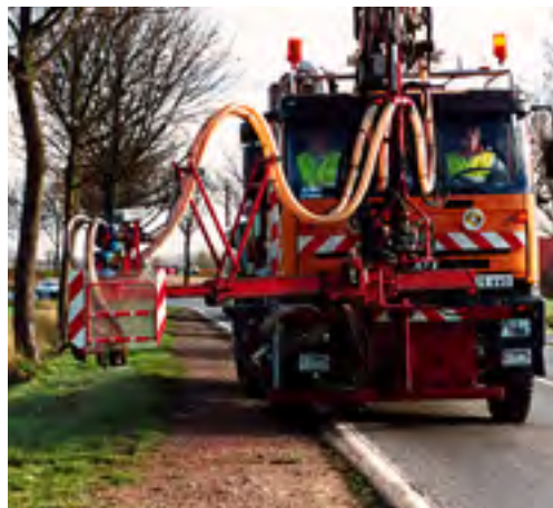
Intervention sécurisée avec un matériel conforme à la norme NF 98-799 et un personnel embarqué (Dde 59, le parc).
