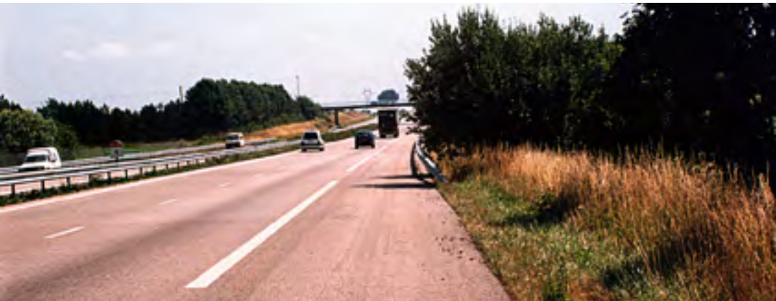
Contrôler le débordement de la végétation sur la chaussée.
