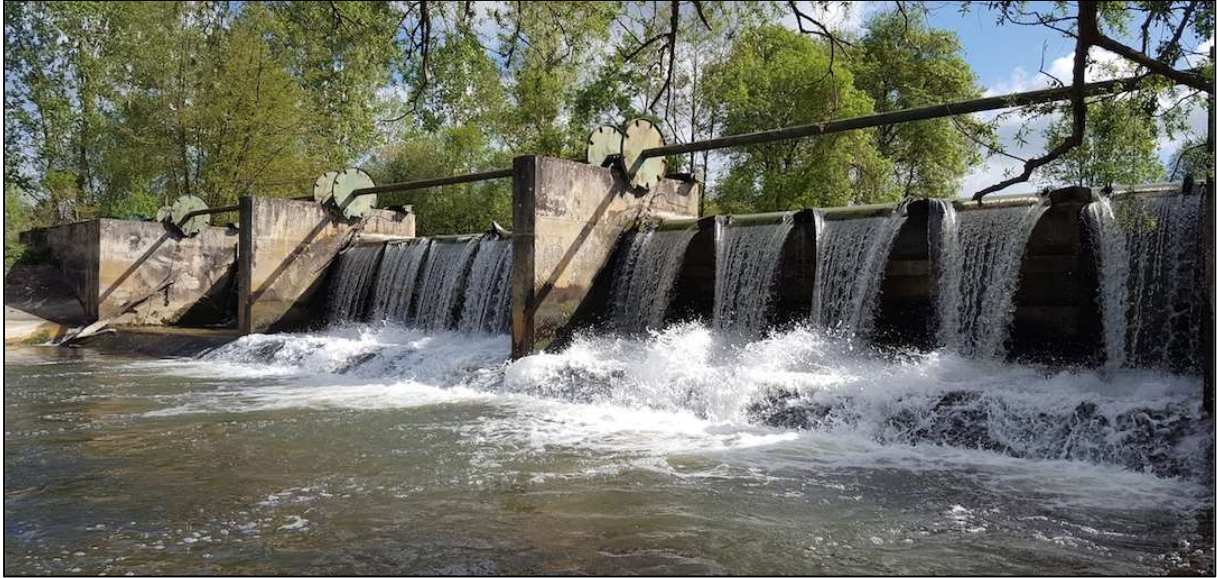
Figure 4 : PV 2 - Vue vers le barrage et les trois vannes (source : Aubry & Associés, nd.).
