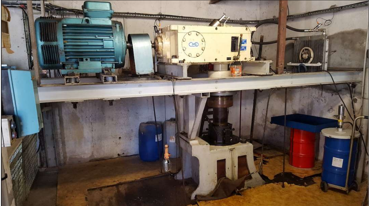
Figure 9 : Turbine de type Fontaine installée dans le moulin de la Roche (source : Aubry & associés, nd).
