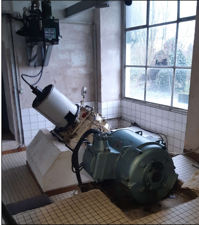
Figure 8 : Turbine de type Kaplan installée dans le moulin de la Roche (source : MTBE, 2021).
