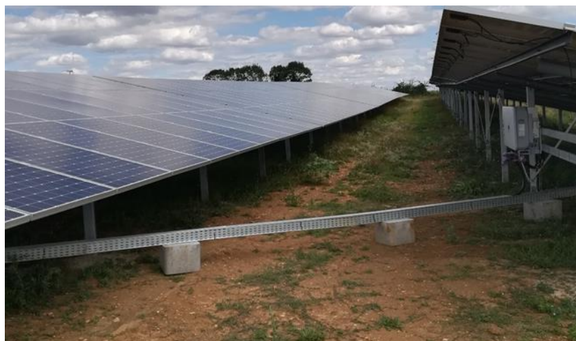
Câbles hors sol – source : LUXEL
