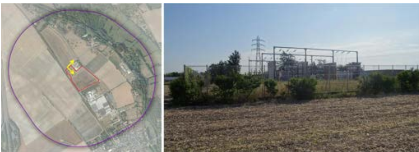
Figure 217 : Photographie du poste source présent au sein de l'AEI (Crédit photo : NCA Environnement)
