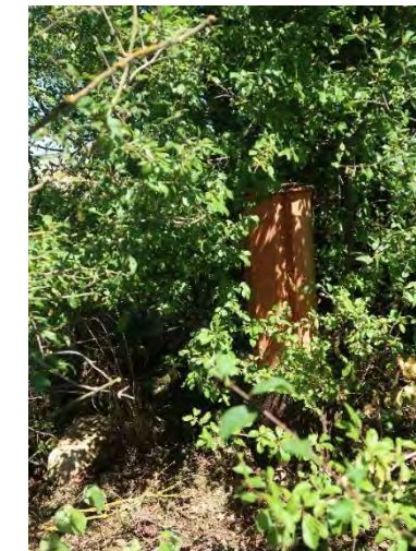
Borne d'irrigation Source : ARTIFEX 2022
