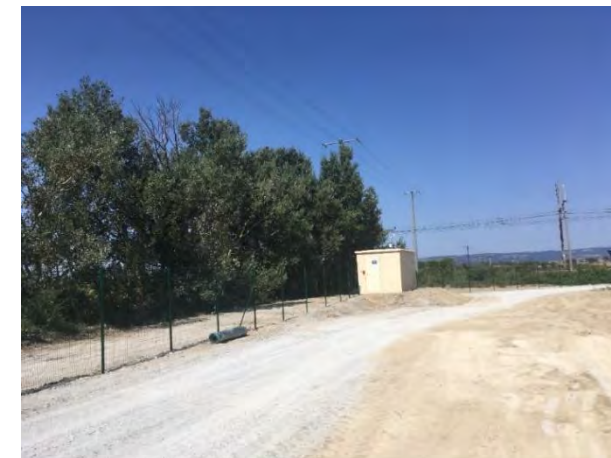
Exemple de poste de livraison
