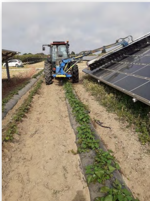
Exemple de procédé de nettoyage des modules
