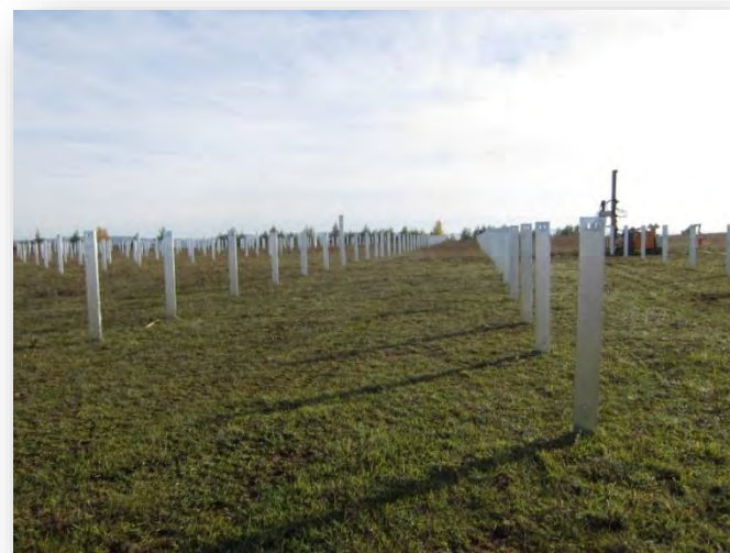
Exemple de pieux battus dans le sol avec une batteuse visible en arrière-plan
