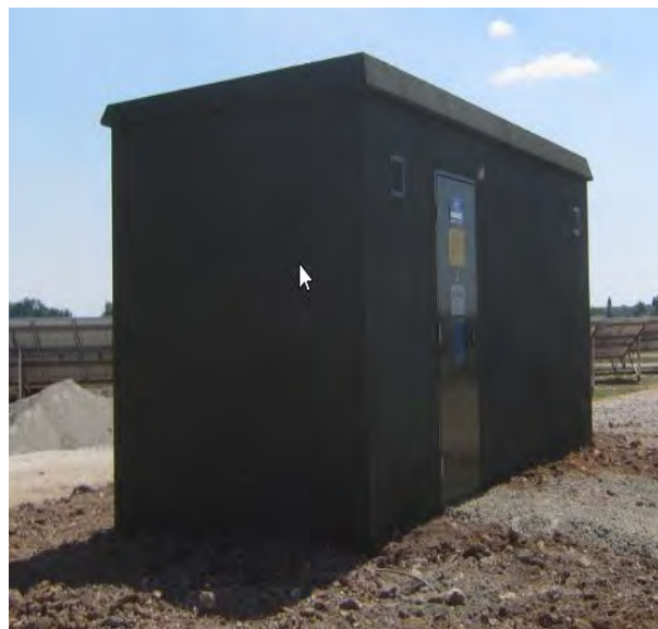
Exemple de poste de conversion « indoor »
