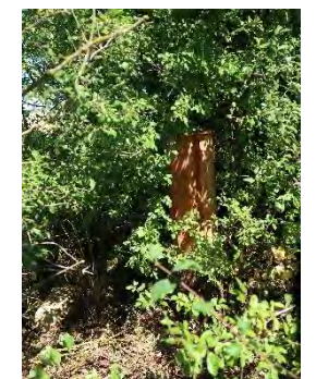
Borne d'irrigation Source : ARTIFEX 2022
